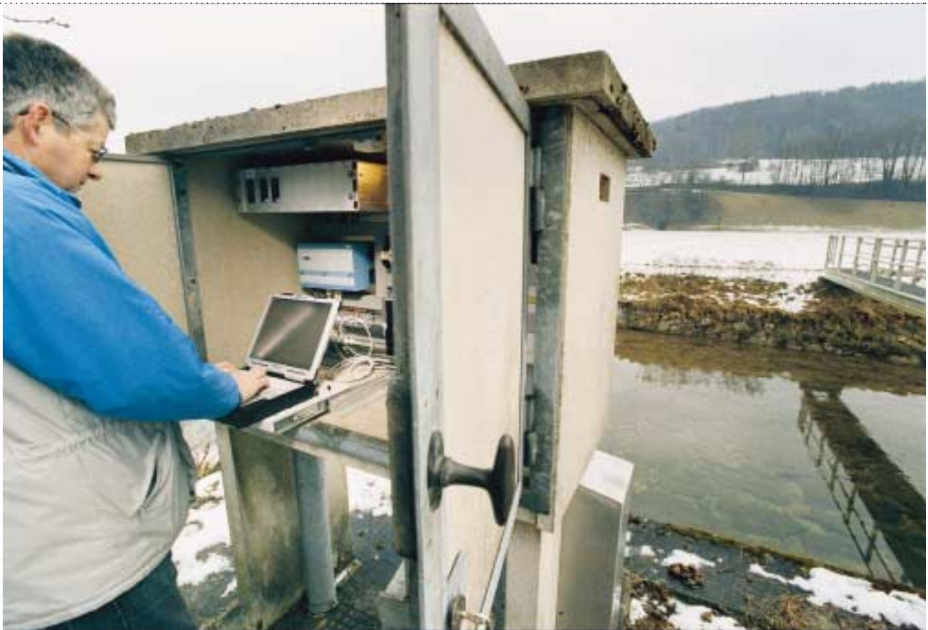
Hightech in Holz: Im Kanton Aargau erfassen robuste Schweizer Rechner Informationen über Wassermenge und Temperatur der Flüsse
